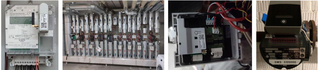
Abbildung 9: Teile der Basisinstallation (Sensorik Energiezähler) im Humboldtgynasium, Solingen
